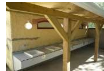
Les pièces de charpente représentent des obstacles. Il faut envisager un prolongement au sol, par des claustras par exemple pour éviter tout heurt
