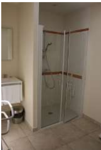
☹ Cette paroi de douche empêche une personne en fauteuil de réaliser un transfert (étroitesse de la douche). Il est important de noter la dimension du fauteuil pour réaliser une douche utilisable
