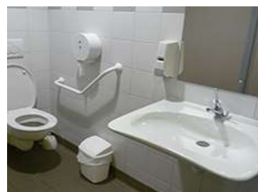
Bel aménagement pour le handicap moteur, mais mobilier pas assez repérable pour le handicap visuel (manque de contraste mur/sol/ équipements sanitaires/ distributeur de papier et savon)
