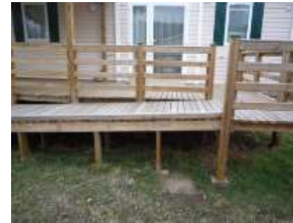
😞 Absence de protection le long du plan incliné
