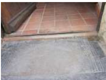
☹ La traverse réduit le passage et le ressaut forme une butée de 5 cm
