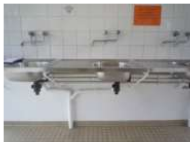
😊 Hauteur conforme, y compris sous le bac de l'évier. Mais c'est la robinetterie qui devra être adaptée sur l'un des éviers
