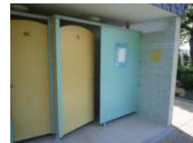
😊 L'aménagement intérieur est conforme. Mais le sens d'ouverture de la porte est à revoir pour garder les espaces de manœuvre suffisants à l'intérieur de la cabine
