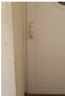
☹ La poignée de la porte se trouve dans l'angle rentrant. Elle est donc difficile à atteindre pour une personne en fauteuil roulant de face, et l'étroitesse ne lui permet pas de se mettre de côté. En effet, les cale-pieds du fauteuil roulant vont butter dans le mur, et la personne sera trop loin pour atteindre la poignée. Réglementairement, les poignées de porte doivent se situer à 40 cm minimum d'un « angle rentrant ». Cette exigence ne s'applique pas pour les bâtiments existants
