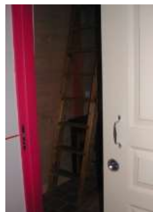
😊 Les portes à galandage sont livrées avec absence de poignée : juste ce rond en enfoncement. Il est absolument inutilisable dès qu'une personne a des difficultés de préhension. Il a ici été doublé d'une poignée plus préhensible (qui aurait pu être un peu plus grosse). Sa position doit permettre d'ouvrir la porte coulissante en conservant la largeur de passage utile
