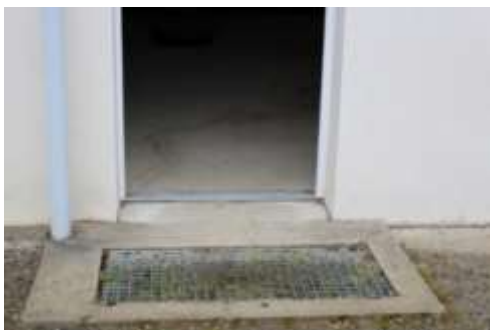
☹ Grille non conforme car les canes peuvent se coincer dans les trous trop larges. Elle doit être supprimée ou remplacée par une grille encastrée à maillage serré (trous inférieurs à 2 cm)
