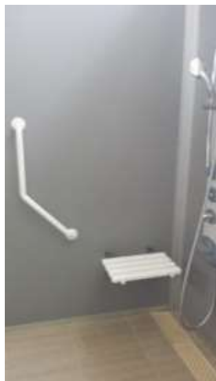
☹ Le siège de douche est trop étroit pour être sécurisant. La barre de transfert, sur le mauvais mur et mal inclinée, n'est pas utilisable
