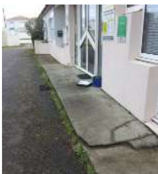
😞 La largeur de ce cheminement trop étroite, combinée à une absence d'espace de débattement de porte et à un ressaut difficile à franchir rend l'accès de cette salle impossible en fauteuil
