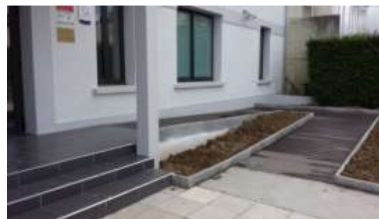
☺ Ces trois marches sont compensées par un plan incliné latéral conforme. En revanche, l'escalier n'est pas totalement conforme : il manque ici la main courante pour franchir les marches, la bande d'éveil à la vigilance avant la descente et les contrastes de couleur sur la première et la dernière contremarche
