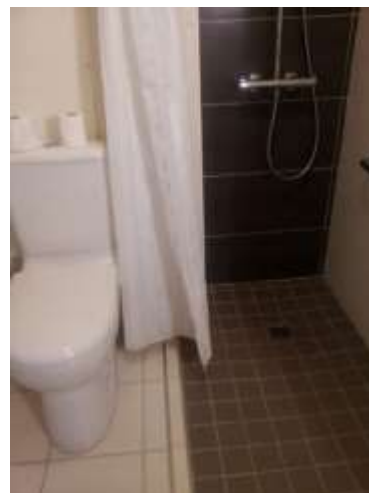
☹ Pourtant à l'italienne, cette douche n'est pas utilisable en fauteuil car il manque l'espace d'usage de 0.80 x 1.30 m nécessaire au transfert
