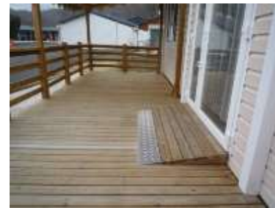
😞 Une terrasse mal ajustée en hauteur. Elle a entraîné la création d'une plan incliné ; ce qui est interdit au droit de la porte d'entrée
