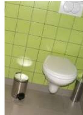
😞 Poubelle trop basse et à pédale, non utilisable pour une personne en fauteuil et qui gêne le recul du fauteuil pour le transfert
