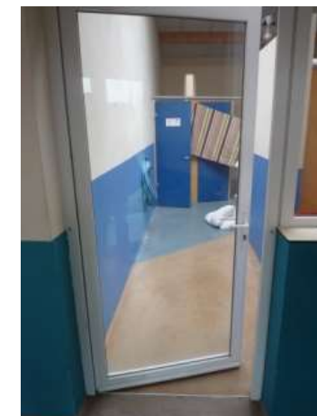
☹ Absence de contraste visuel sur la porte vitrée. Obligation de poser des bandes visuelles contrastées
