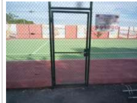
😊 Court de tennis accessible par une porte de largeur 0.90m. A noter cependant le ressaut non conforme qui fera l'objet d'un traitement
