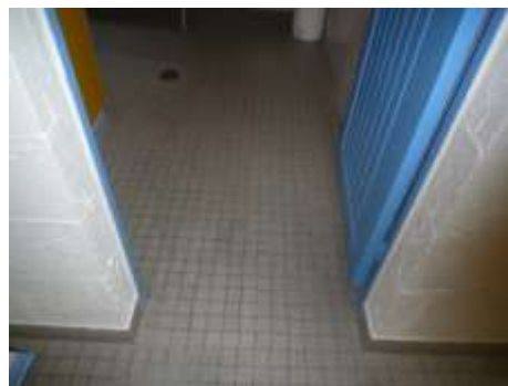
😊 La largeur de ce passage est de 77 cm. Les portes principales desservant des locaux pouvant recevoir moins de 100 personnes peuvent avoir une largeur de passage utile de 0.77m pour les bâtiments existants uniquement
