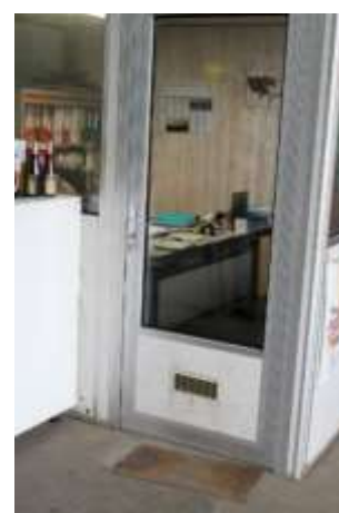
☹️ Le bureau d'accueil n'est pas accessible (porte inférieur à 77 cm de passage utile)
