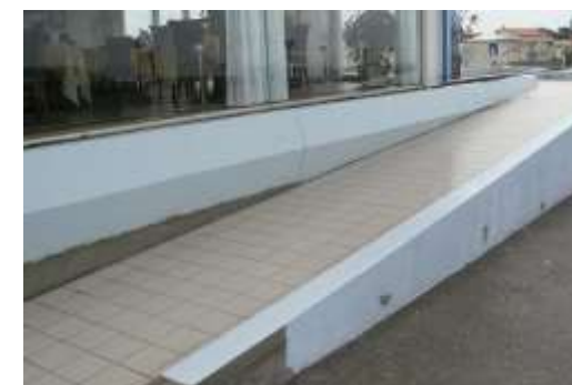
😞 Une rampe d'accès ne doit pas excéder 5% et être accompagnée de palier de repos régulier (espace plan entre 2 pentes). Elle est sinon pénible à la montée et dangereuse à la descente
