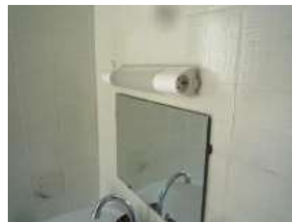
☹ Une prise de courant non atteignable dans cette cabine
